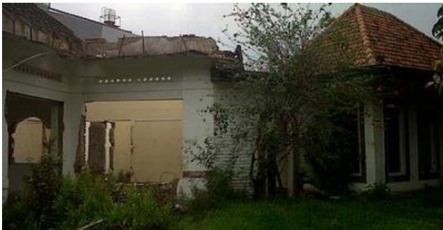
Foto 4. Rumah Cantik di Jalan Cik Dik Tiro No. 62 tampak terbangkalai dan separuh bangunannya sudah dibongkar Sumber : Kompas.com edisi Jumat, 2 Desember 2011 | 04:09 WIB
